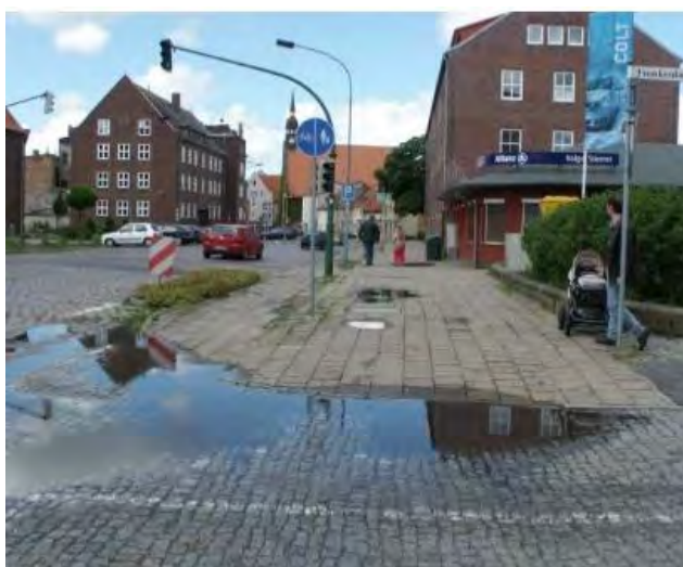
Frankendamm vor der Sanierung
